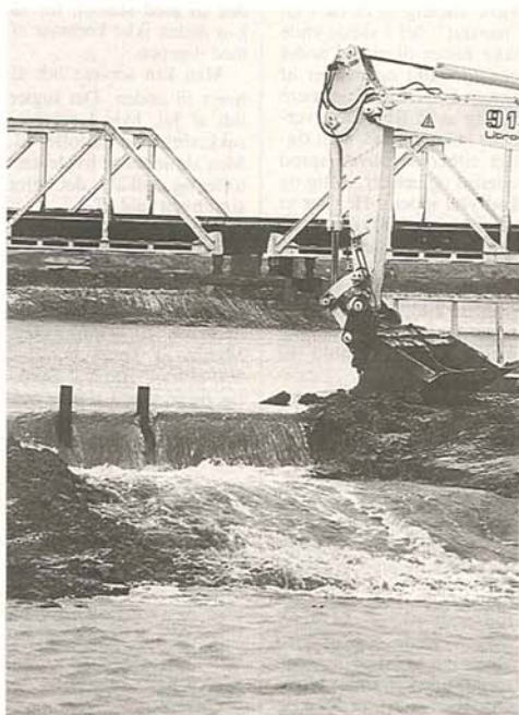
Vandet fik frit løb. Efterhånden som vandstanden i den nuværende Skjern Å vil falde, vil entreprenøren lægge spærring ud, så al vandet presses over i de nye, oprindelige slyngninger.
